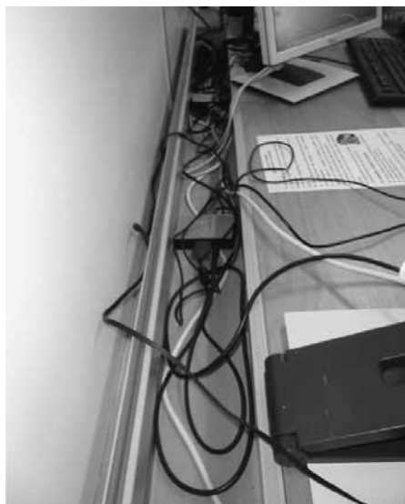
Slika 4: Kanal, v katerem so kabli in odjemalci.
