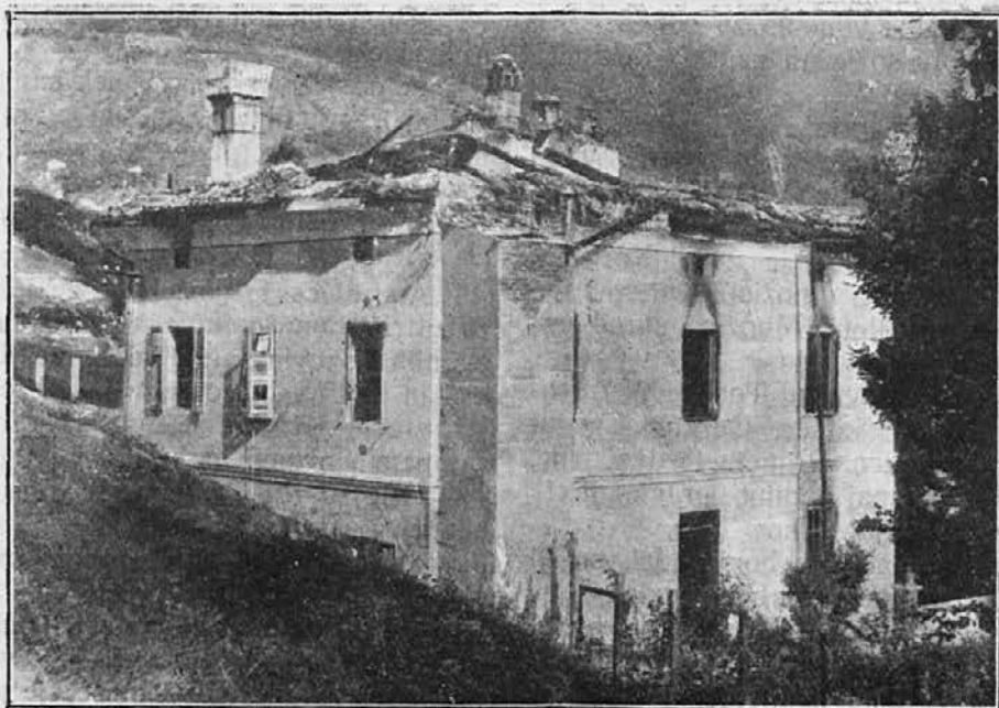
Požgano župnišče v Drežnici.
