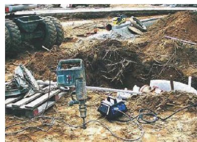
Slika 8: Po nekaterih statistikah se glede nezgod z električnim udarom kritična zlasti manjša gradbišča. Zaradi neugodnih razmer je tu vedno obvezna uporaba zaščitnih stikal na diferenčni tok kljub uporabi orodja razreda II. Če na razpolago ni ustreznih gradbenih razdelilnih omar, si lahko pomagamo s prenosnimi stikali PRCD. (Vir: www.kopp-ag.de )
