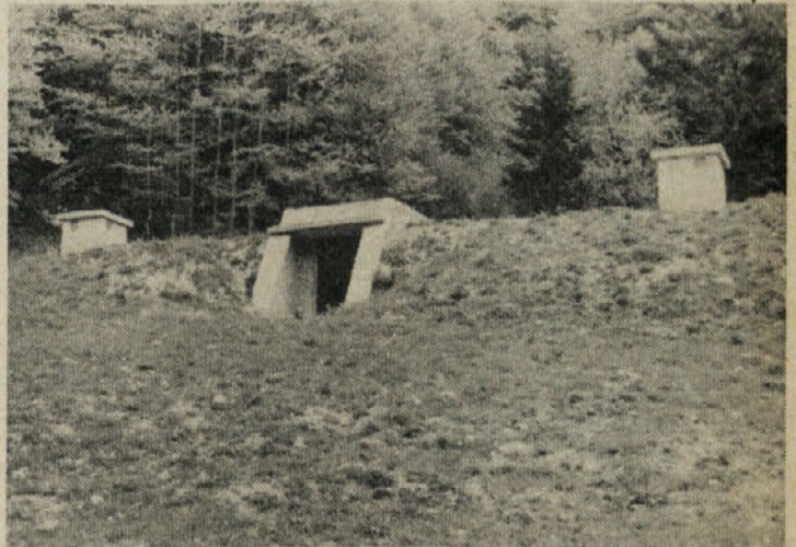
Vodovod v Koprivniku, ki je bil zgrajen s sredstvi iz samoprispevka, je velika pridobitev za krajanje te oddaljene vasi, prav tako pa tudi rezervoarja, ki zagotavljata vodo krajanom v sušnem obdobju.
