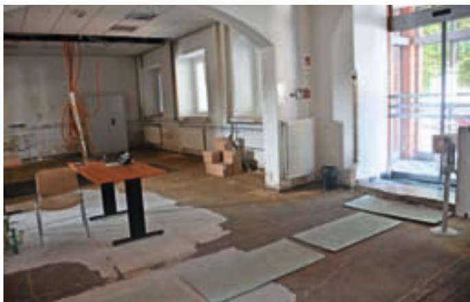
Poplavljeni so bili tudi kletni in pritlični prostori občinske stavbe. Na fotografiji je trenutno stanje v delu, kjer je bil Krajevni urad Medvode. Pretekli teden je bilo zaključeno javno naročilo za nujno rekonstrukcijo. / Foto: Maja Bertoncelj
