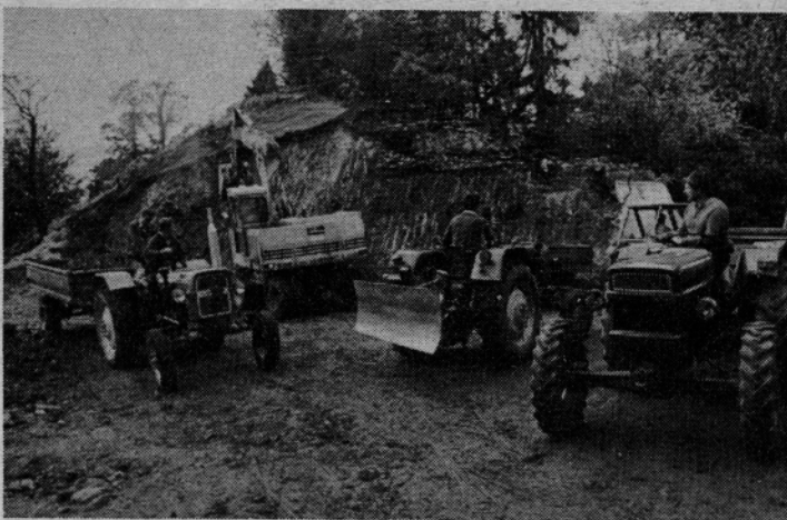
Pogorelo gospodarsko poslopje pri Punčuhu se že obnavlja. Hitra in učinkovita pomoč prihaja od vseh strani in potrjuje se spet solidarnost na najvišji stopnji. Stroji GG Nazarje pomagajo pri obnovi.
