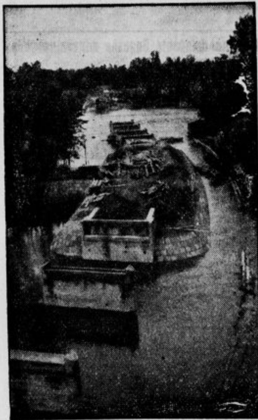
Pogled na cestni nasip med graditvijo inundacijskih mostov. V ozadju Mura, čes katero vodi sedaj glavni most.
