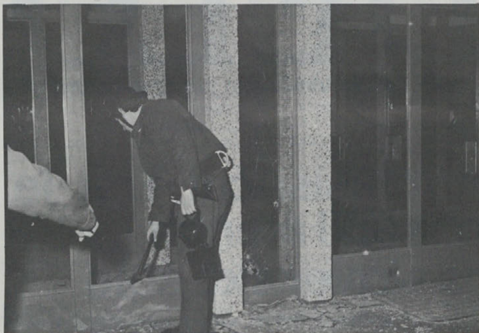
Posledice atentata: okna so razbita, stene močno poškodovane. Kaj bi se zgodilo, če bi v trenutku eksplozije bili v šolskih prostorih ljudje?
