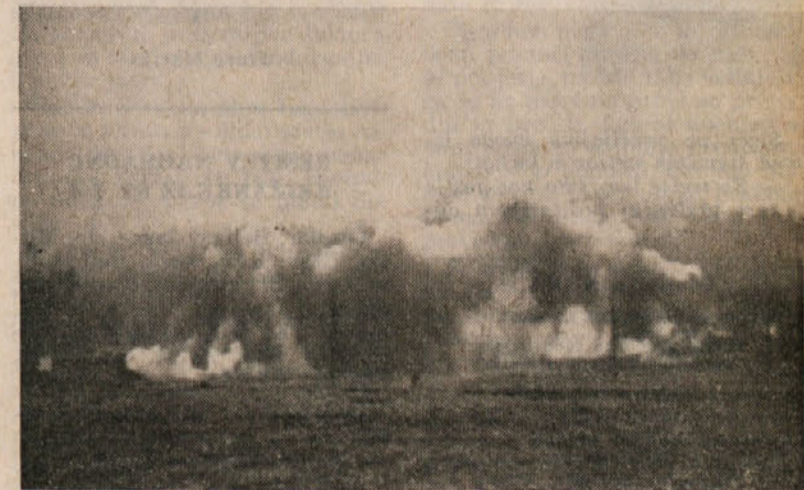
Pri našem podjetju smo prvič uporabili »rafalno miniranje« pri zemeljskih delih v Storah. In uspeh? Tudi nad 10 000 m 3 zrahljane zemlje v nekaj sekundah
