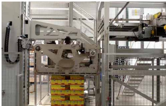
» Eden ključnih stebrov uspeha je integracija naprednih pogonskih sistemov in sistemov za krmiljenje/nadzor Mitsubishi Electrica, ki zagotavljajo zanesljivost, prilagodljivost in hitrost.
