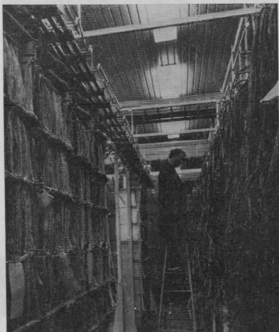
Montaža avtomatske telefonske centrale Iskra Metaconta 10 C v Mostah. V prihodnjih dveh letih bo Iskra izdelala in montirala še 13 avtomatskih elektronskih telefonskih central za tranzitni promet za jugoslovansko pt omrežje
