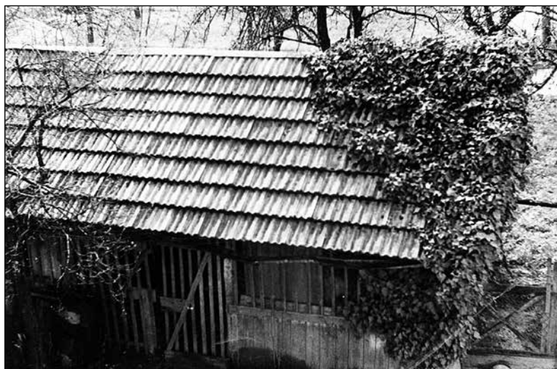
Objekt, kjer je bilo kegljišče na Frtici. Foto: arhiv družine Gogala iz Selc
