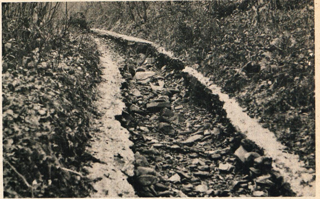
Tole je še ostalo od ceste proti Šimanskemu hribu. Tamkajšnji občani pridejo sedaj do svojih domov le po kolovoznih poteh preko Velike in Male Štange. Popravilo ceste je izredno nujno! (Foto: Go)
