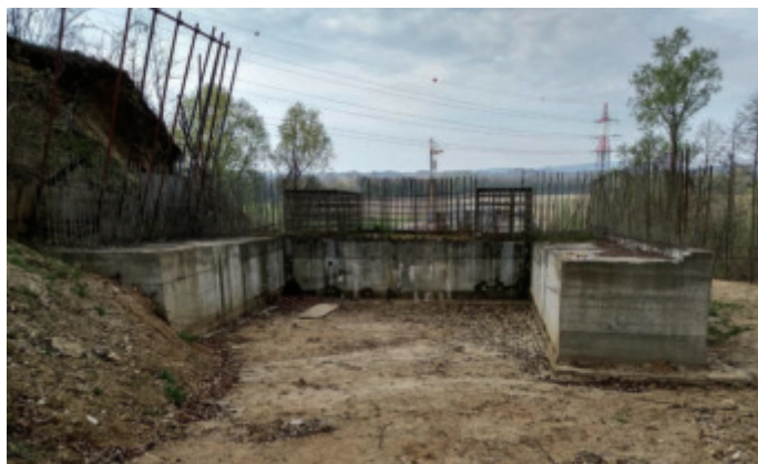
Slika 19 • Delno zasut opornik v osi 7.
