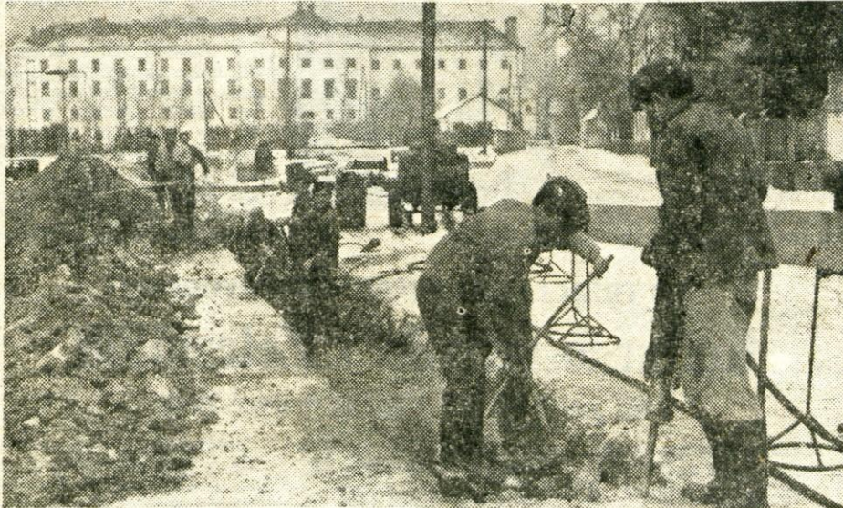
Prvi metri nove kanalizacije so izkopani. Dela je prevzel najboljši ponudnik — Komunalno podjetje z Jesenic. Na sliki prvi meter nove kanalizacije (Foto: F. Perdan)
