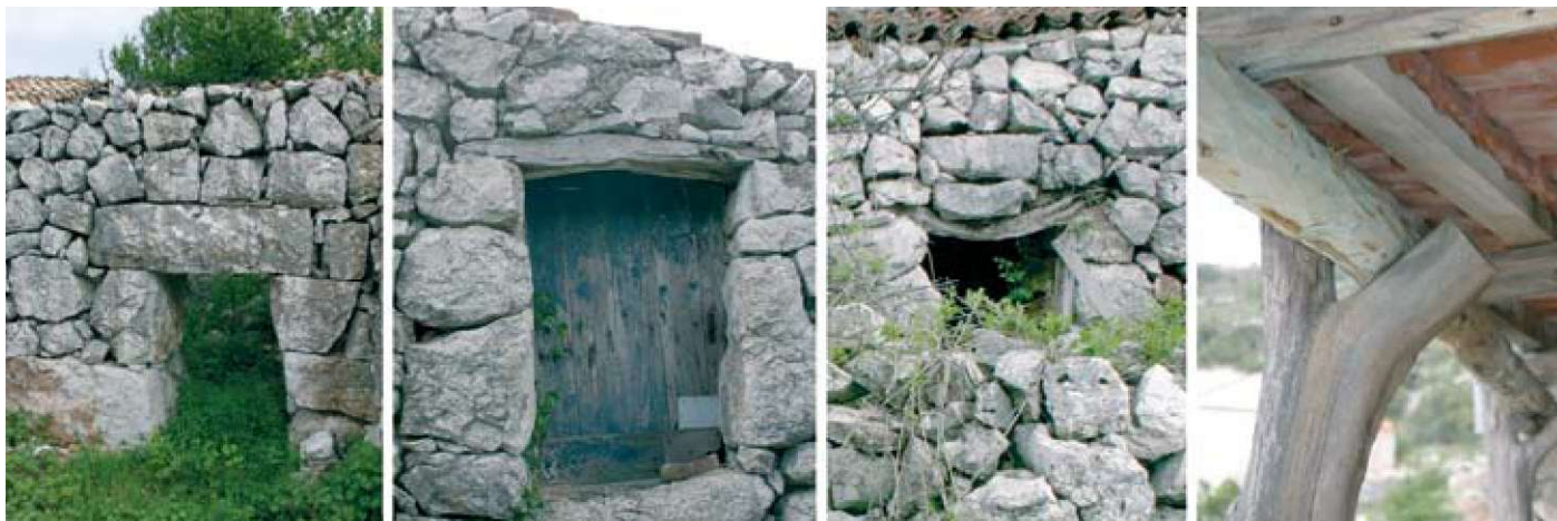
Slika 6: Na območju Kvarnerja in Dalmacije je les dragoceno gradivo. To izpričujejo skromne lesene preklade in smiselna uporaba rogovil pri vertikalnih podpornikih. Nekatere preklade so izvedene napačno bodisi z izbiro nezadostnih presekov bodisi z napačno postavitvijo - razpon z usločeno preklado. Pravi antipod so predimenzionirane kamnite preklade.
