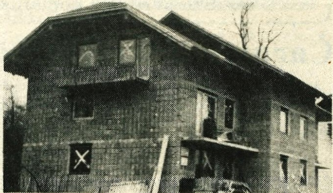
Zapuže – Za delavce tovarne Sukno v Zapužah so pred nekaj leti zgradili dva manjša bloka. Ker še vedno primanjkuje stanovanj, so lani začeli graditi še tretji blok, v katerem bo šest stanovanj. Blok je zdaj pod streho in predvidevajo, da bo useljuv letos poleti. – B. B.
