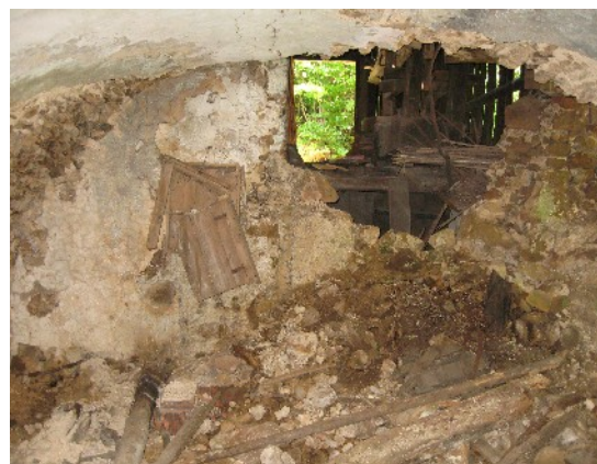
Podrti del kletnega oboka ob prvotnem vhodu
