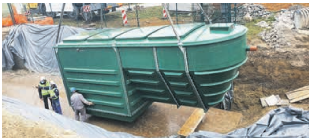
Primarni bazen, kjer se bo zbiralo odpadno blato.
