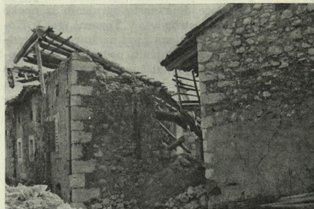
Sl. 8. Ohranjeni vogali poškodovanih hiš v Breginju po drugem potresu
