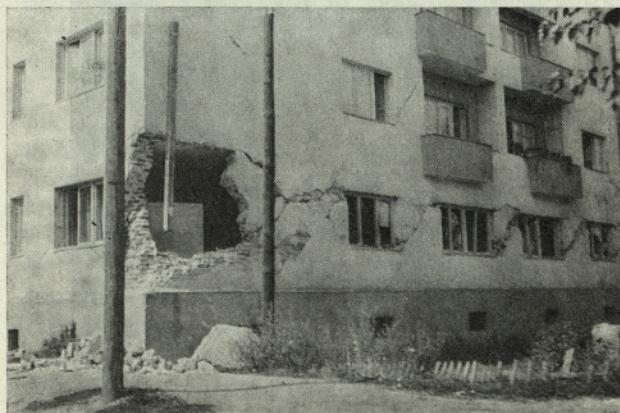
Sl. 2. Poškodovana stanovanjska stavba v Skopju
