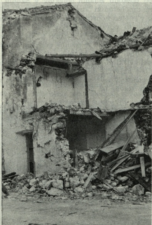
Sl. 3. Porušitev stavbe v Breginju
