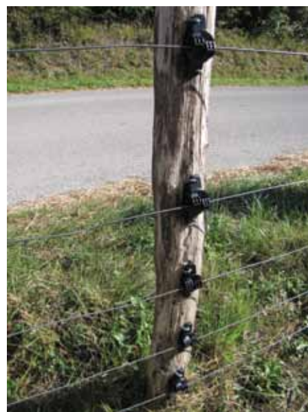
Slika 1: Nosilni kol v obodni ograji, na katerem so kakovostni in nepoškodovani plastični izolatorji.
