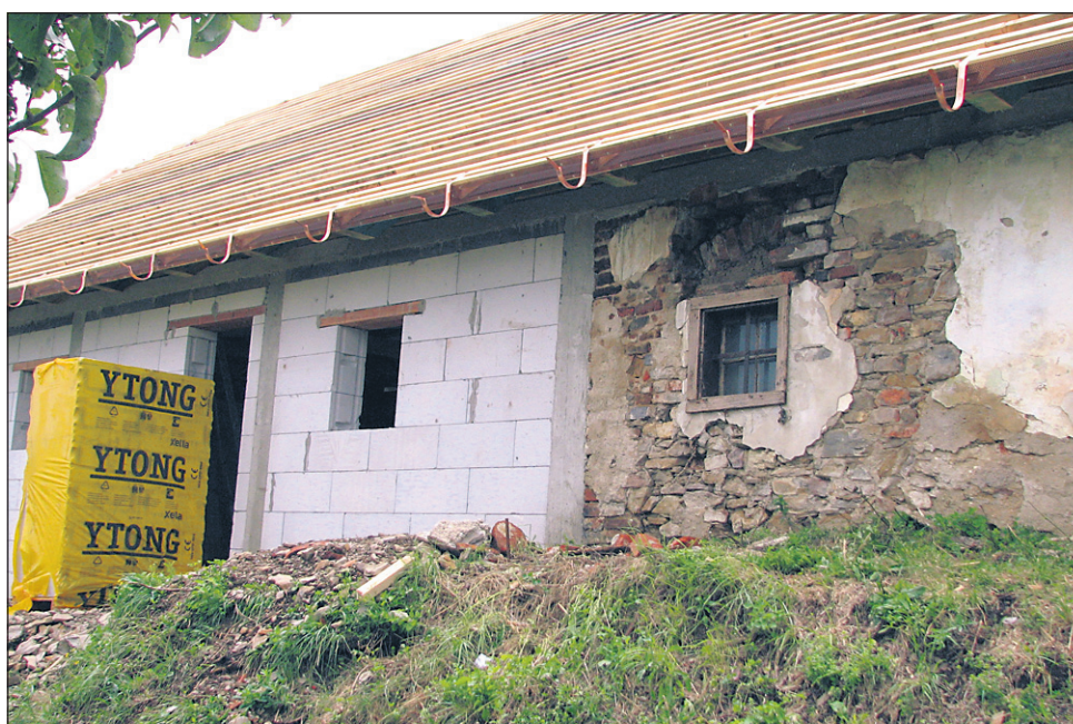
Tako se dograjuje viničarska bajta – muzej; skedenj oz. gospodarsko poslopje bo sezidano z ytong opeko, streha pa z opečno kritino in bakrenimi žlebovi ...
