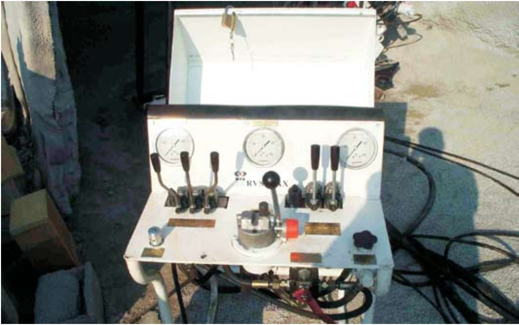
Figure 9. Control desk Slika 9. Kontrolno krmilna plošča
