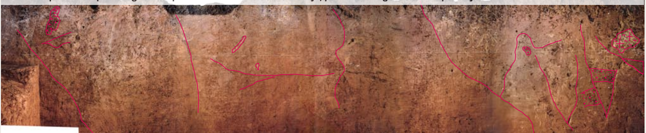
233 Južni profil razkopa na Rogovili. Na posnetku so izrisani nekateri detajli, pomembni za geološko interpretacijo.
