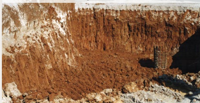
234 Gradbena jama za postavitve novega nadvoza čez bodočo avtocesto, tik ob starem nadvozu. V vrtinah na tej lokaciji je dokazano, da so rdeča kraška tla debela kar 13m. Ta lokacija se nahaja okoli 100m vzhodno od razkopa na Rogovili.
