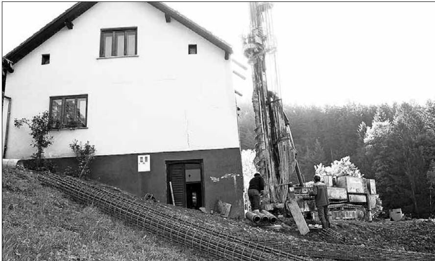
Podjetje CM Celje je pričelo s sanacijo plazu pod domačijo Oblak, kjer je plaz na hiši že povzročil razpoke in zapretel, da se bo zrušila. (Foto: Benjamin Kanjir)
