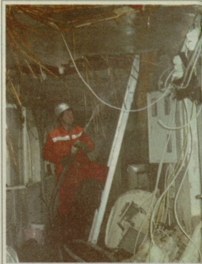
Eno izmed stanovanj dvanaest ur po izbruhu požara.
