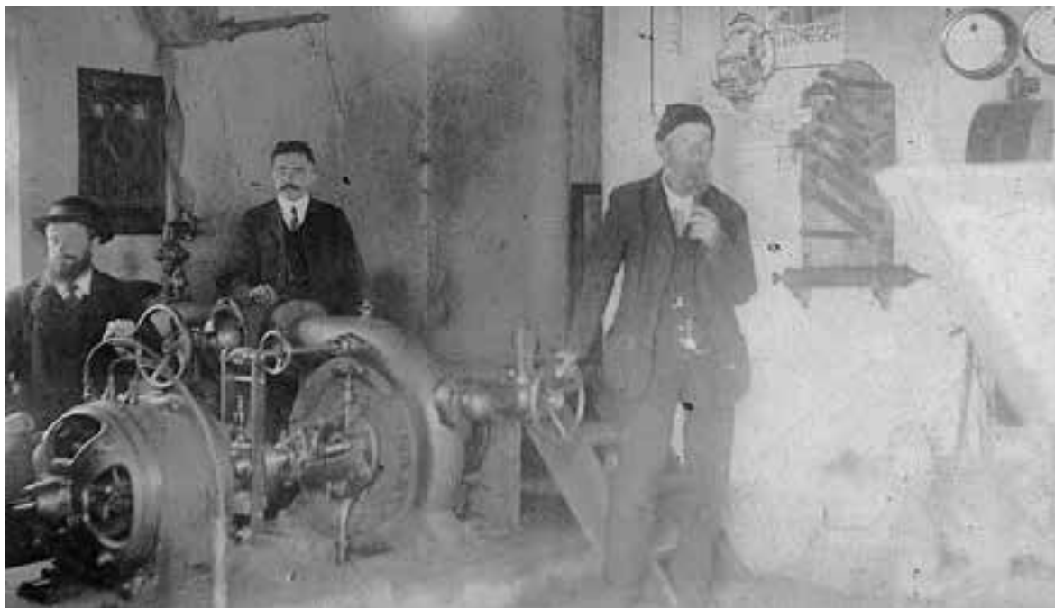
Dobračeva 15: strojnica elektrarne na Dobračevi, 13. oktobra 1912; z leve Valentin Poljanšek, Franc Temelj in Janez Poljanšek. / Modrijanov družinski arhiv
