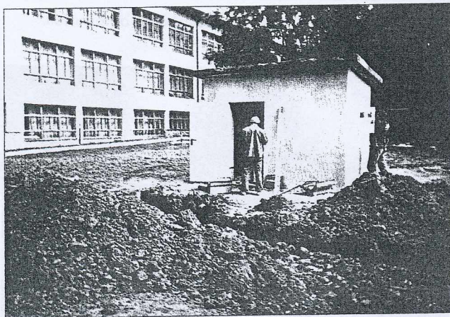
Na novo urejena razdelilna postaja za vodovod.
