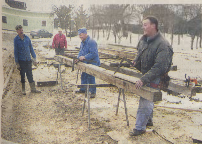
Na kmetiji so mnogi dan po požaru priskočili na pomoč.
