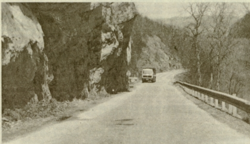
Magistralna cesta od Celja do Zidanega Mosta ni le v izredno slabem stanju, ampak je tudi polna najrazličnejših nevarnih pasti.
