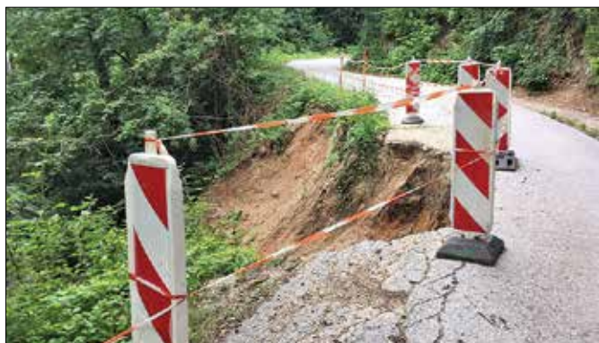
Stanje na cesti Negojnice-Klašte pred sanacijo (Fotodokumentacija Občina Rečica ob Savinji)
