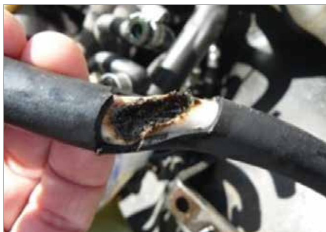
Zmanjšán presek vodnika zaradi poškodbe pri vrtanju
