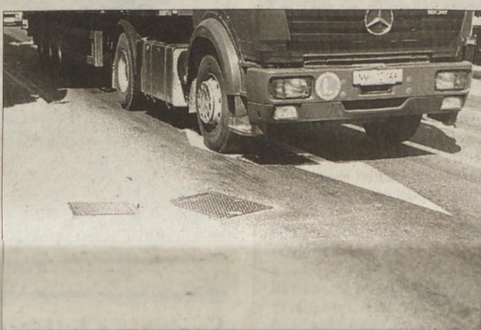
Je za nastale probleme z odtokom kriv tovrni promet po magistralni cesti? Pred leti obnovljeno cestišče se je zaradi nenehnega tovrnega prometa že sesedlo in stisnilo kanalizacijske cevi.
