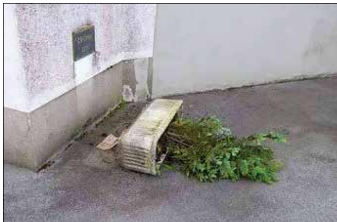
Pred vhodom v športno dvorano je bilo razbito betonsko korito za rože, poškodovana je bila tudi varnostna kamera.
