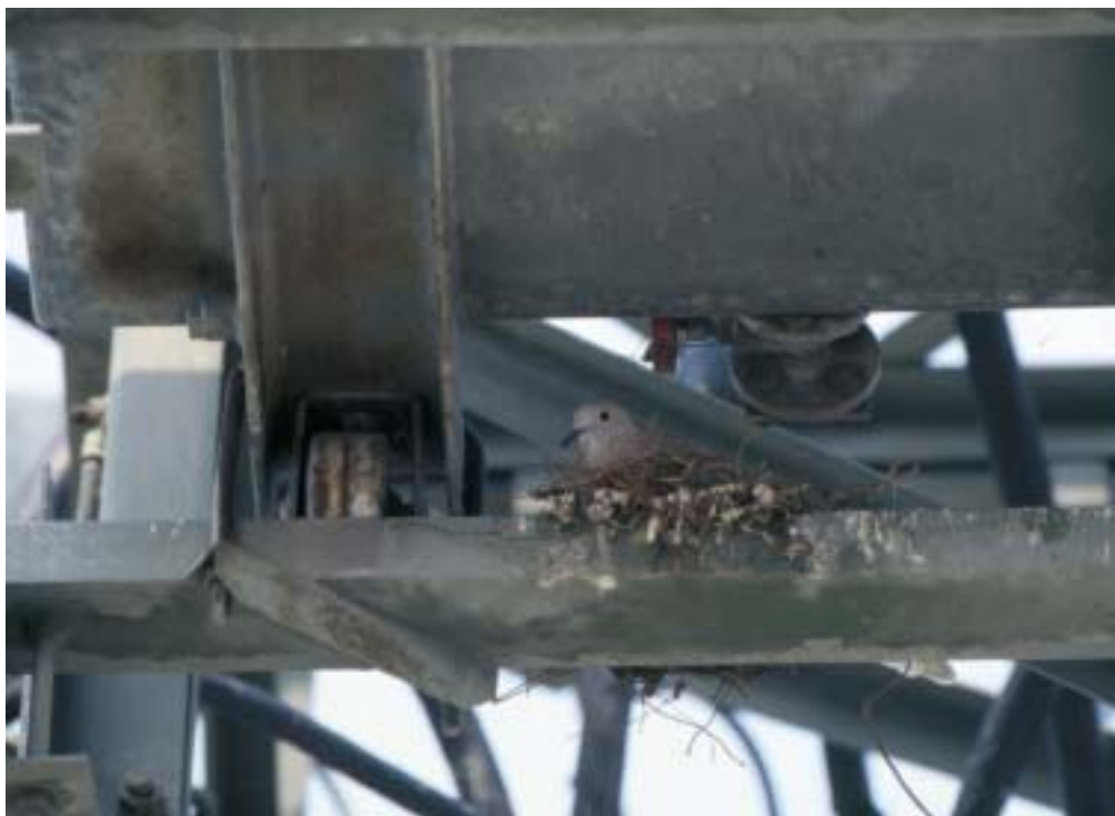
Turška grlica si je gnezdo naredila na kovinskem transformatorju.
