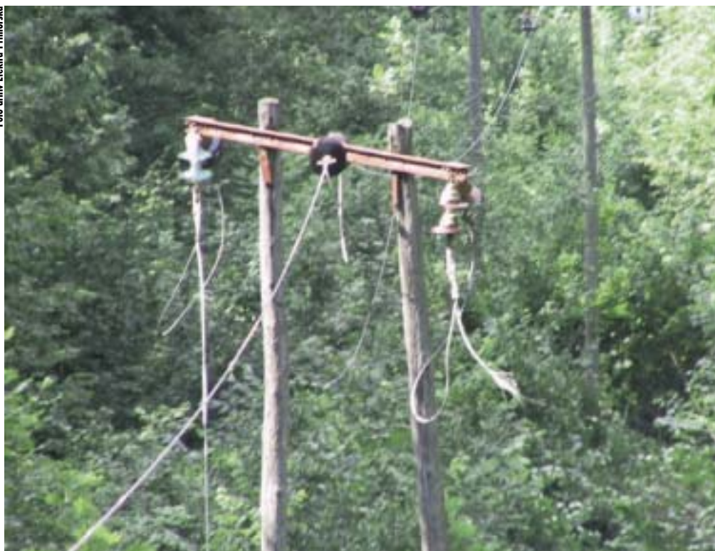
Tipičen primer škode, ki jo je poletno neurje povzročilo na omrežju Elektra Primorska.
