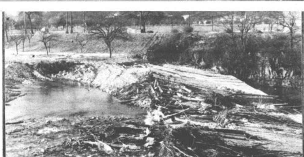
Jesenske poplave so v Gornji Savinjski dolini povzročile veliko škode. Zlasti močno so bili poškodovani jezovi in drugi vodnogospodarski objekti. Odpravljanje posledic je seveda veliko počasnejše od podivjanih voda, pa naj so razlogi za to takšni ali drugačni.
