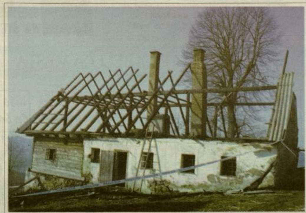
Goreti so začele saje v dimniku...
