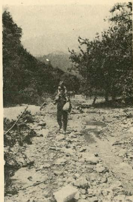
Tu je bil včasih asfalt, zdaj pa je ostala le žalostna podoba neurja
