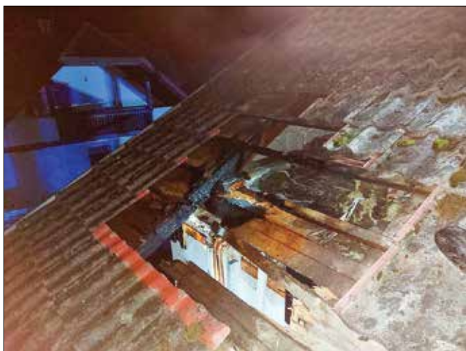
Gasilci so nemudoma posredovali in s tem preprečili večjo škodo na objektu. (Foto: arhiv PGD Gornji Grad)
