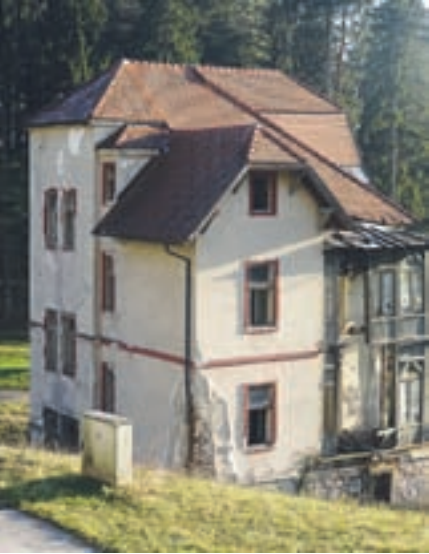
Objekt je že pošteno načel zob časa.
