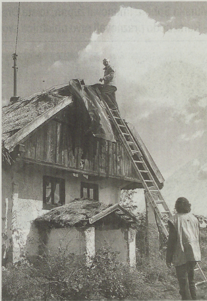
Razpadajočo s slamo krito streho kranjčeve zidanice so pokrili s folijo.
