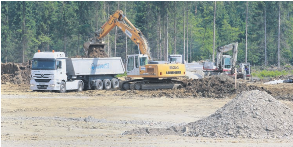
Toming inženiring naj bi del zemlje, izkopane pri celjskem Vrtcu Hudinja, deponiral na pregradi med jezeroma. Za to dejanje ni imel okoljevarstvenega dovoljenja. Na pregrado sicer vozi tudi zemljo, ki jo kopljejo ob gradnji Lidlovega logističnega centra v Arnovskem gozdu. Za slednjo ima ustrezna dovoljenja.
