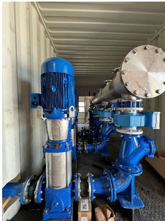
Obnovljeno črpališče na namakalnem sistemu Novega Celja (A. Sirše)
