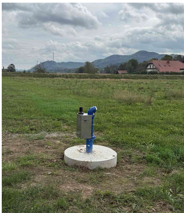
Daljinsko voden hidrant na namakalnem sistemu Novega Celja B (Foto: A. Sirše)
