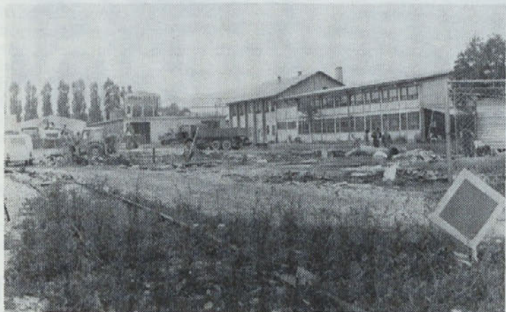
STARO SKLADIŠČE JE ŽE PODRTO — JULIJ 82
