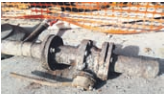
Dotrajana več desetletij stara zaporna armatura
