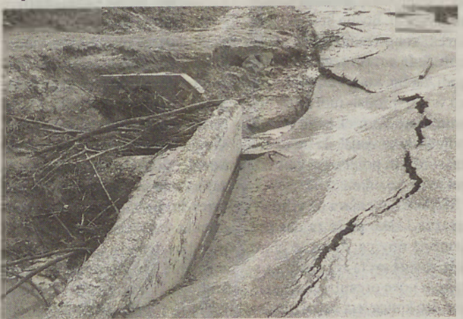
Največ škode v cankovski občini je zaradi uničenega mostu v Gornjih Črncih – tako je izgledal po uničujočem nalivu.
