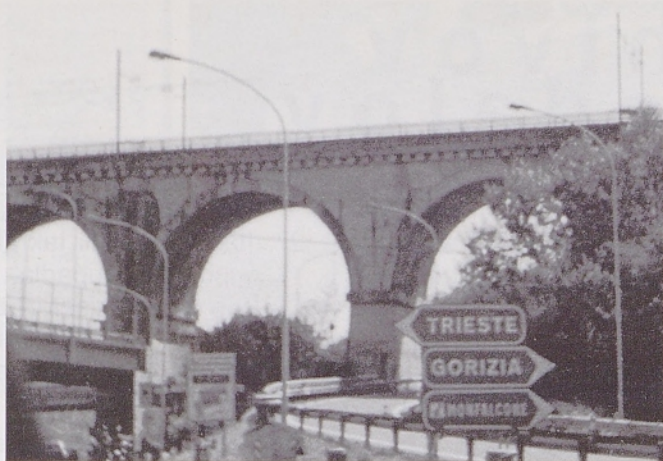
Levi steber obkroža več kamnitih obročev, s čimer se razlikuje od ostalih stebrov viadukta, ki niso bili poškodovani (fotografirano iz avta).
