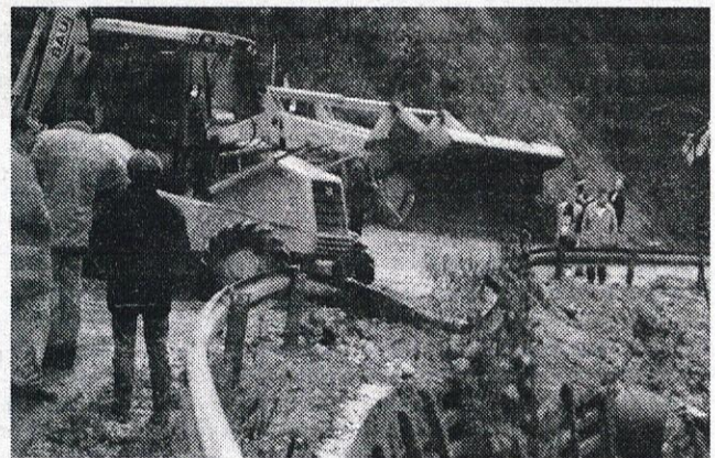
Odstranjevanje plazovine s ceste proti Kamniški Bistrici
