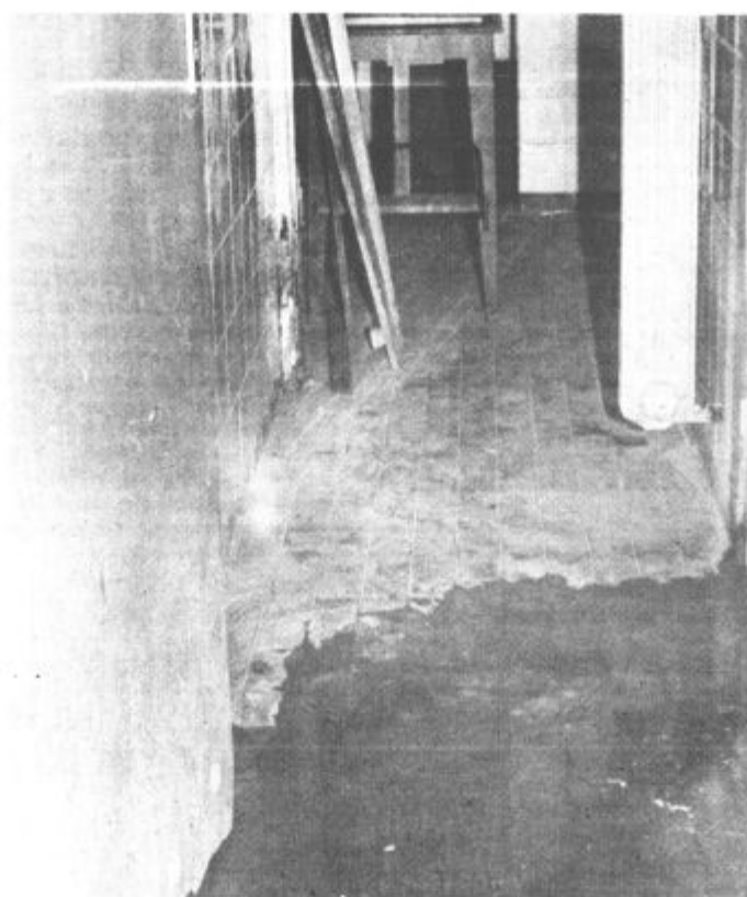
V kletne prostore vdira voda. Sanacija bo končana še letos.
