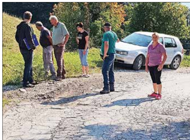
Sprotno vzdrževanje lokalne ceste Križ-Florjan-Krnica ne zadošča več, potrebna bo njena rekonstrukcija. (Foto: Jožica Rihter)
